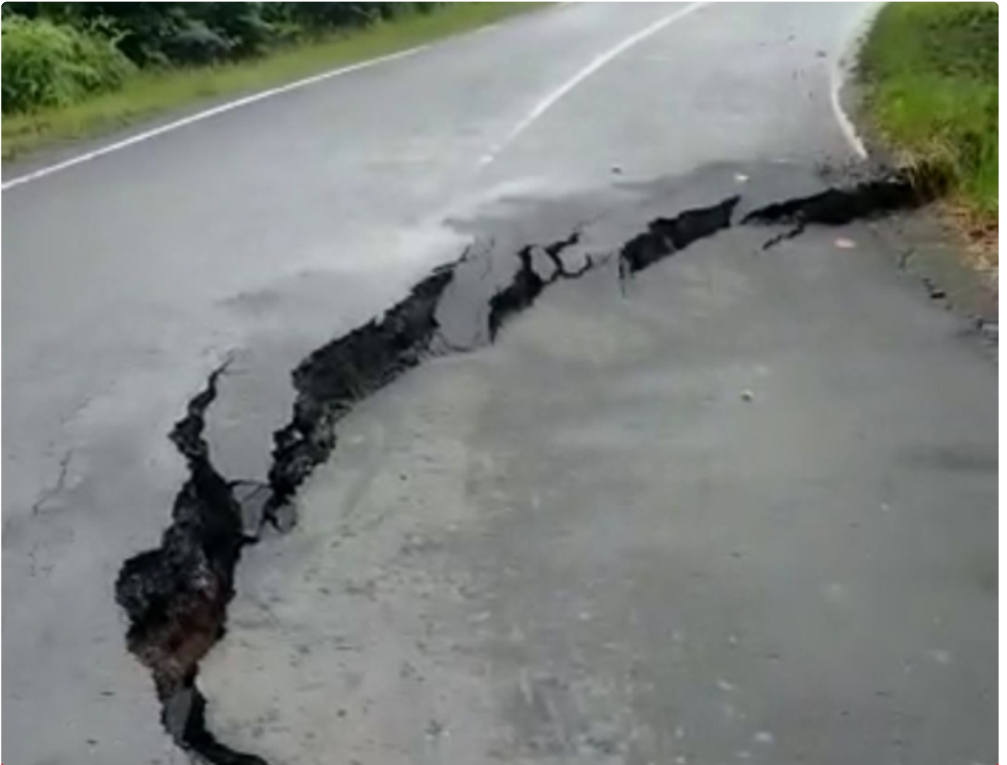
Gambar: Kondisi Ruas Jalan Nasional Kuala Kurun - Sei Hanyo Yang Mau Longsor
